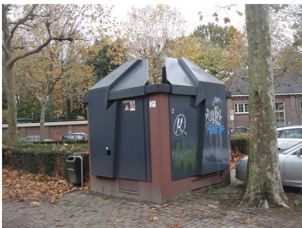
Meelstr 2a K trafo
