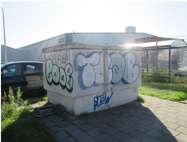
D Koolenlaan trafohuisje
